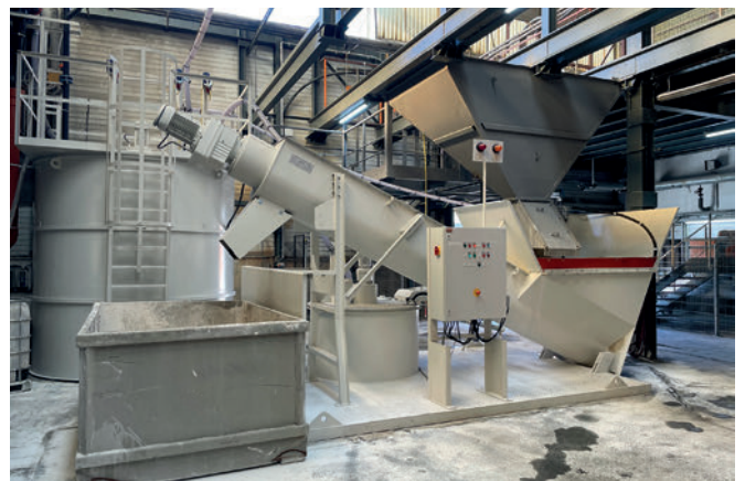
Instalación de reciclaje de hormigón residual de Wema Stahl- und Maschinenbau
