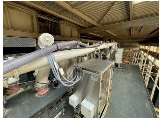
El alcance de suministro de Teka incluyó, además, una plataforma de pesaje, depósitos de reserva para los áridos, básculas de ligante, equipos de filtración para extracción de polvo, tornillos sin fin para los ligantes y una instalación dosificadora de fibras.
