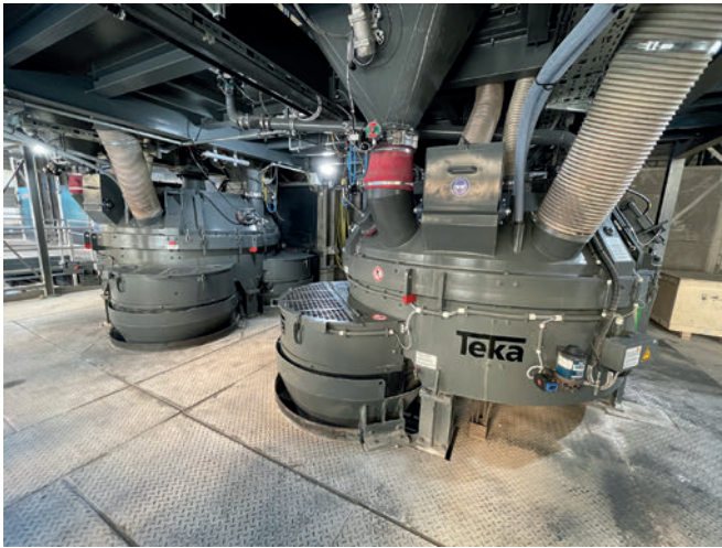
El corazón de la nueva instalación mezcladora son las dos mezcladoras de turbina de tipo THT G -2- V de Teka.
