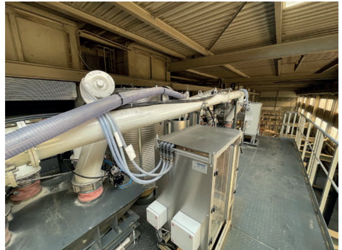
Zum Lieferumfang von Teka zählen des Weiteren eine Waagenbühne, Vorratsbehälter für die Gesteinskörnungen, Bindemittelwaagen, Entstaubungsfiltergeräte, Bindemittelschnecken und eine Faserdosieranlage.
