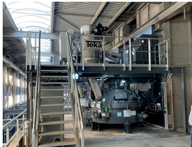
Blick auf die neue Mischanlage bei Lithonplus
